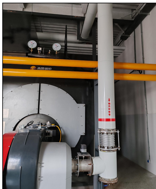
烟气循环低氮燃烧装置
