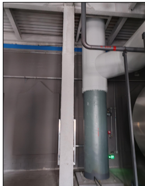
天然气锅炉排气筒
