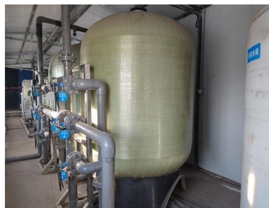
石英砂过滤罐
