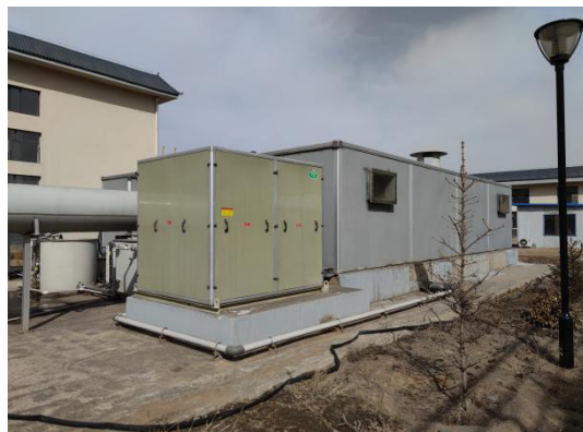
除臭生物滤塔
