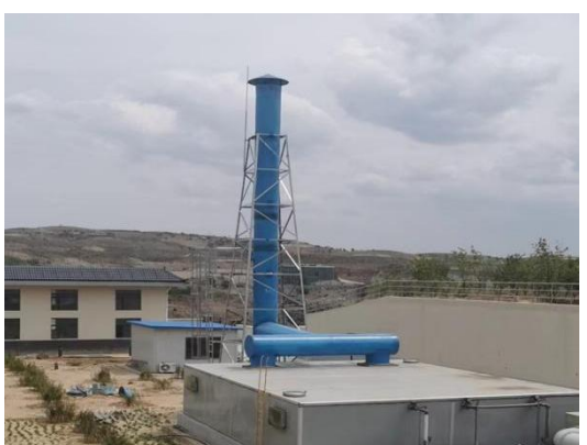
除臭系统排气筒
