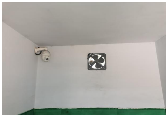
通风系统和监控设备
