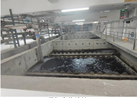
曝气生物滤池
