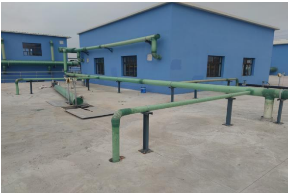
臭气收集管道
