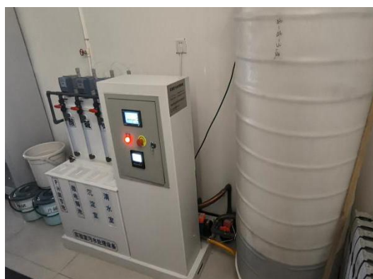
一体化处理设施
