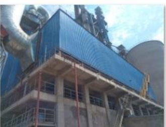
大除尘器 (2).jpg
