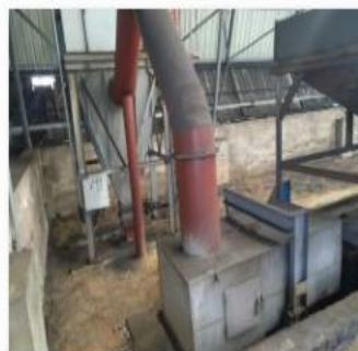
堆煤场除尘 (3).jpg
