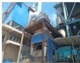
大除尘器2.ina
