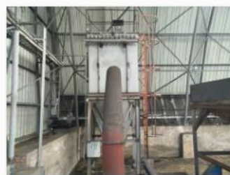
堆煤场除尘 (2).jpg
