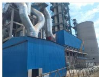
除尘器烟道 (1).jpg
