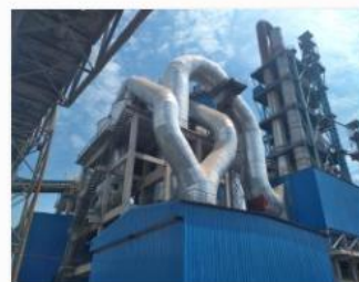
除尘器烟道 (2).jpg
