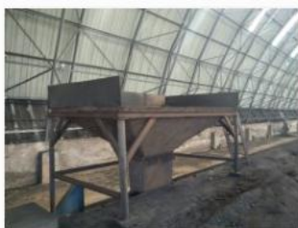
堆煤场除尘 (1).jpg
