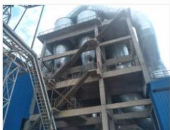
大除尘器.jpg
