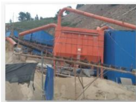
破筛分等工段共设置 1 台布袋除尘器
