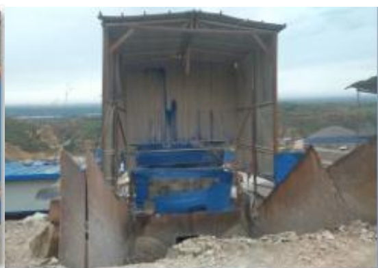
进料口喷淋设施及彩钢封闭
