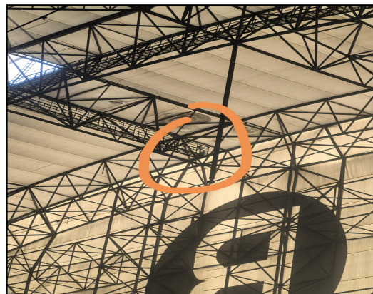
棚内喷淋装置
