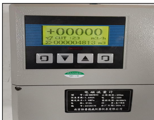
2025年4月9日开始向疏干水管网调试供水流量计
