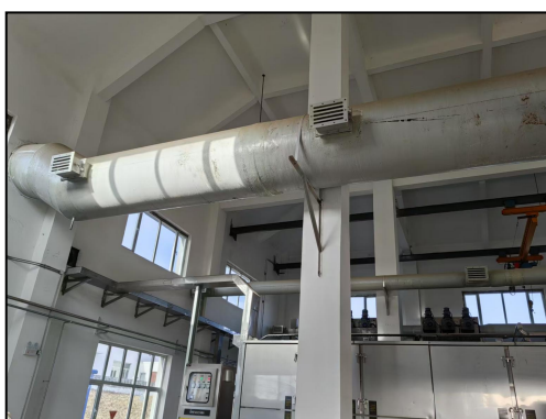
污泥脱水间风管
