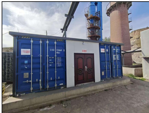
矿井水处理站深度处理车间
