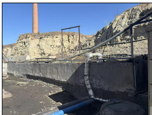
矿井水处理站原水池
