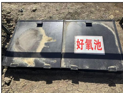
生活污水处理站好氧池密闭加盖
