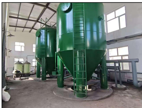
矿井水处理站预处理车间
