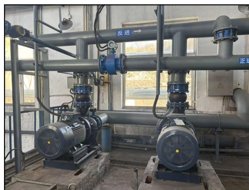
基础减震设施
