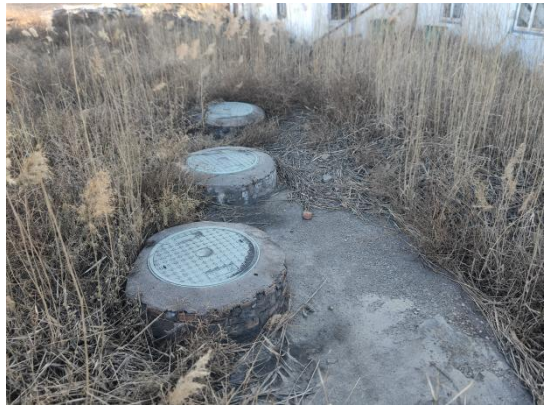
生活污水沉淀池
