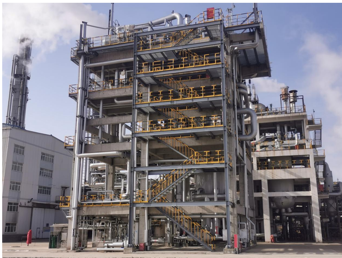
尾气碱洗塔系统
