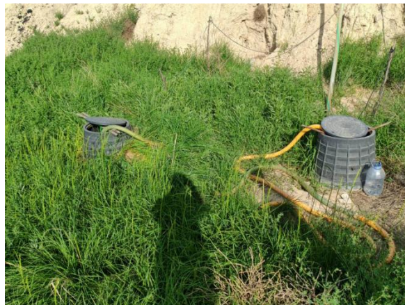
生活区污水储存罐
