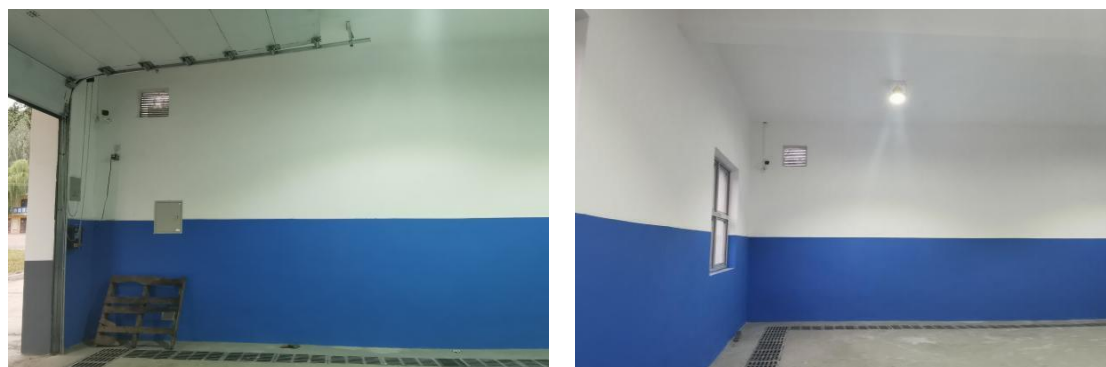
通风系统及监控系统
