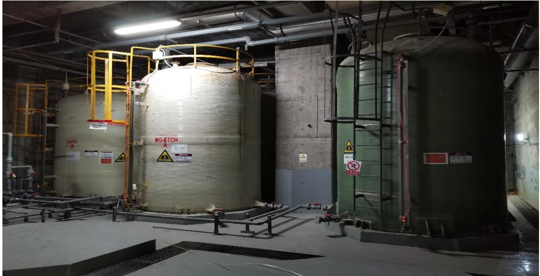
图 5.2-5 废酸液暂存区
