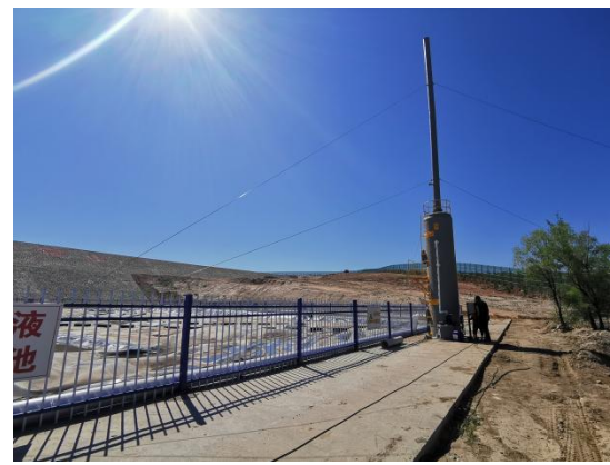
渗滤液调节池生物除臭塔
