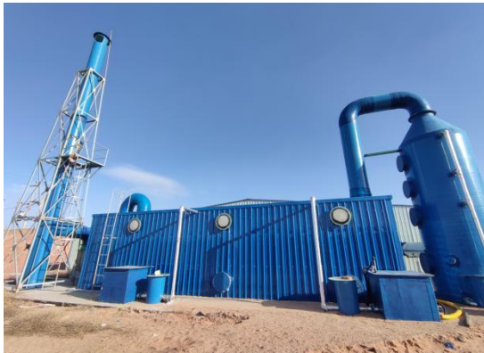
调节池除臭系统
