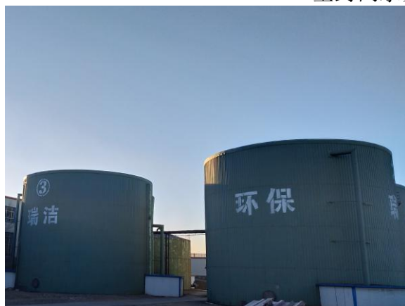
厌氧发酵罐区
